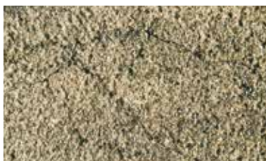
Старая штукатурка с трещинами
